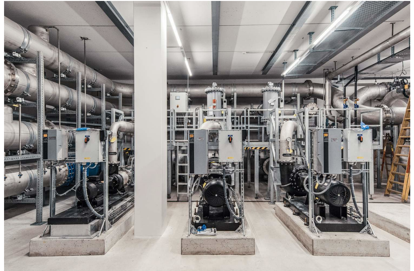
Seewasser Pumpen und Filter
